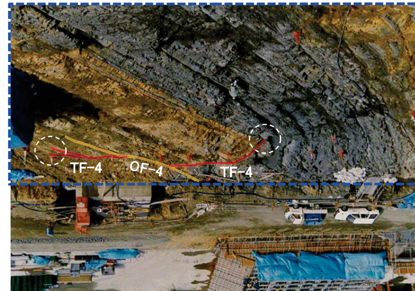
2号原子炉建屋掘削時の岩盤状況写真 (写真は天地を反転)
