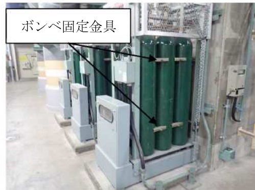
液化炭酸ガス (1号DG建屋)
