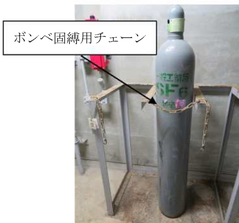
六フッ化硫黄 (屋内開閉所)
