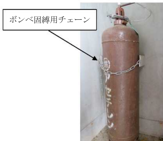
アセチレン (ガスボンベ室)
