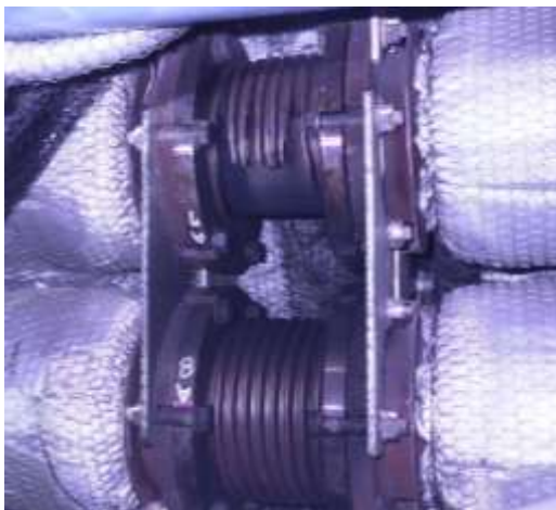
破損した伸縮継手
