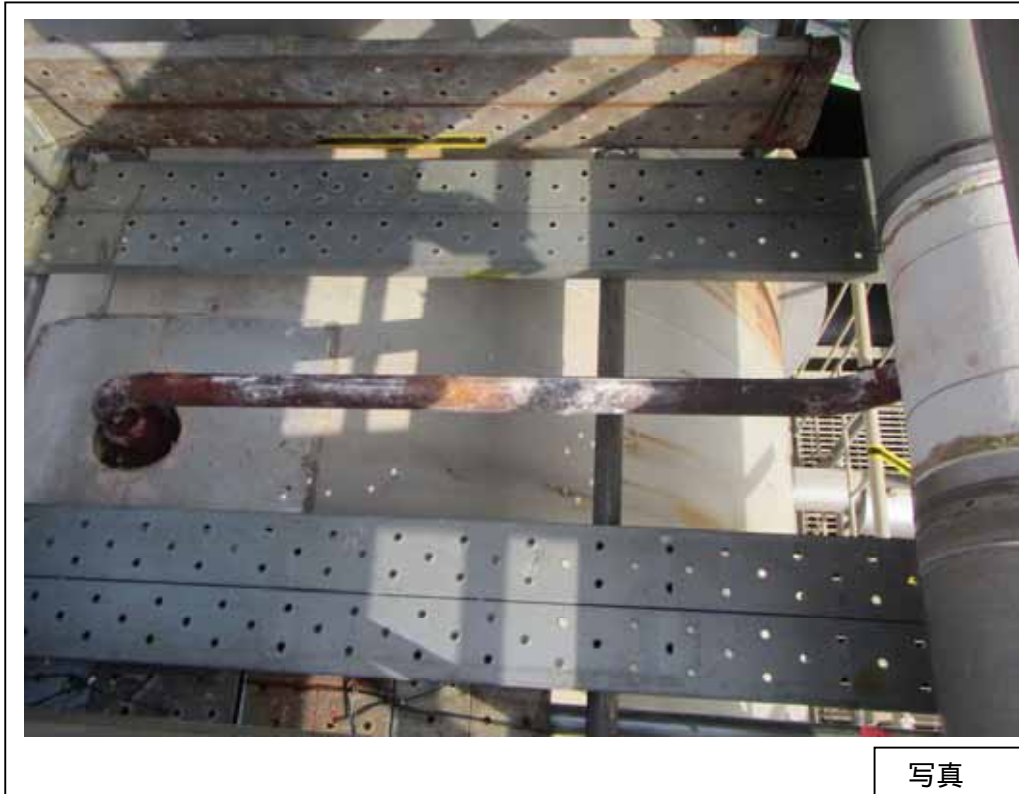
蒸気漏れ配管【3 B脱気器の第5 空気抜き管】
