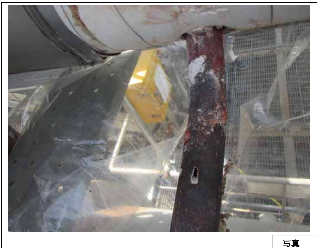
蒸気漏れ箇所【3 B脱気器の第5 空気抜き管】
