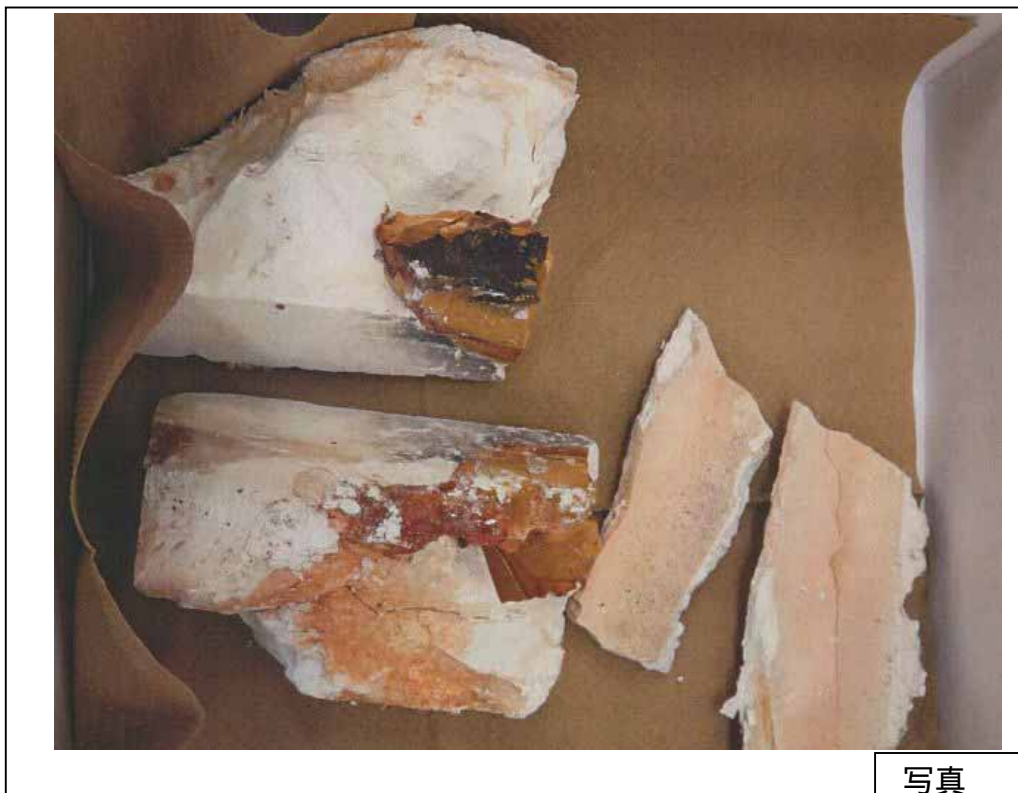
保温材内面の状況【3 B脱気器の第5 空気抜き管】
